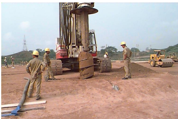
Foto: Iniciando la perforación del primer pilote cuatro meses después de la firma del contrato.
