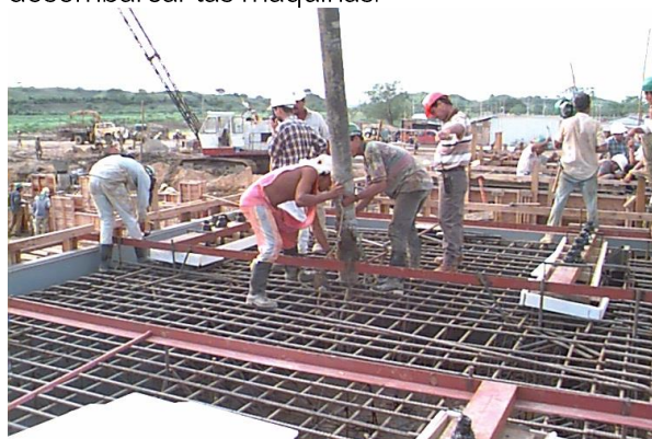
Foto: Hormigonado de la bancada en segunda fase del generador de la TG1 en el quinto mes de Proyecto.
